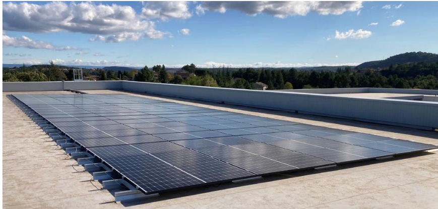
Photo @ID Solaire Prades
