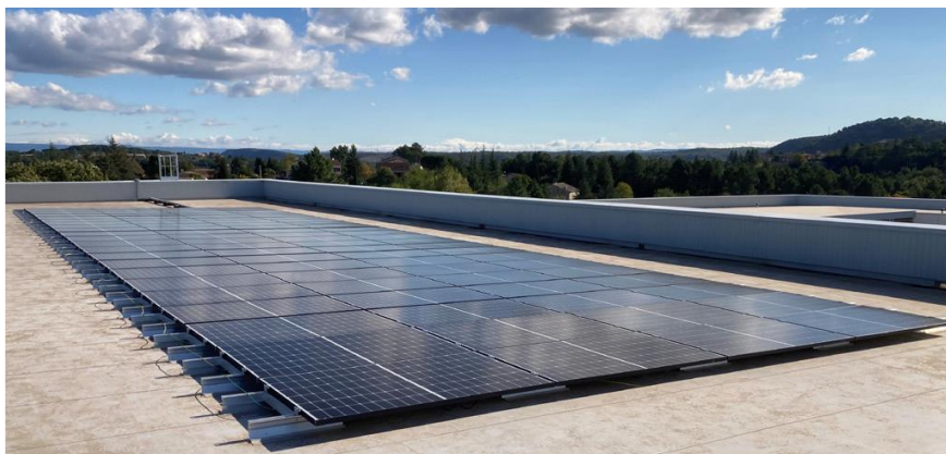
Photo @ID Solaire Prades
