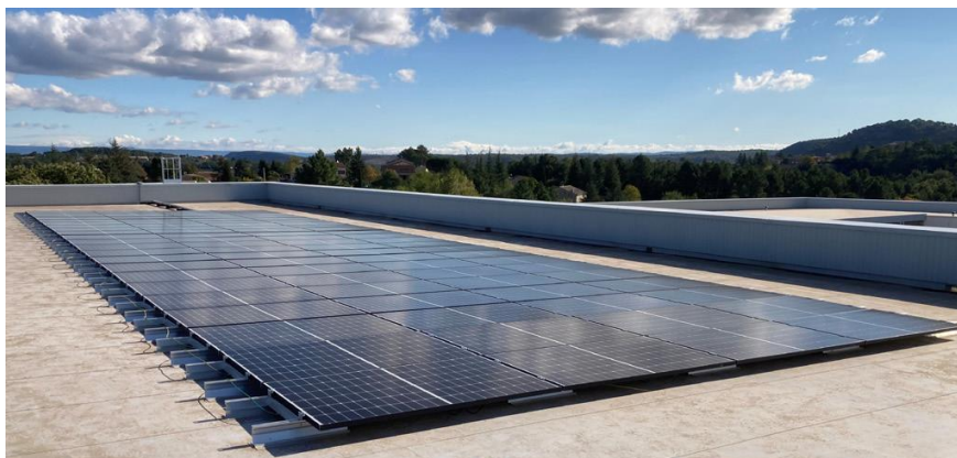
© Photo ID Solaire
